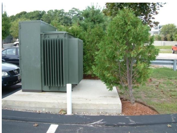
Figura 64: Transformador do tipo pedestal em rede semienterrada.
